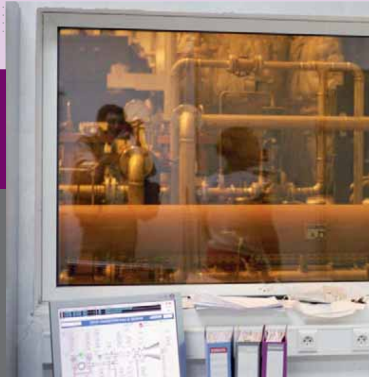
▲ Centrale géothermique de Bouillante, à la Guadeloupe.
