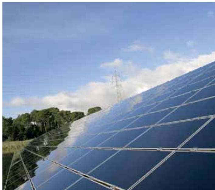
Ferme solaire de Narbonne (France).
